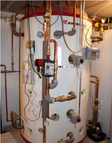
Vesivaraaja, joka sijaitsee kellarissa takan alapuolella. Valokuva: Ella Suhonen.
